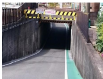
アンダーパス監視
